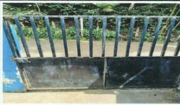
Foto 2: CAMBIAR LA PUERTA DE LA ENTRADA A METAL
